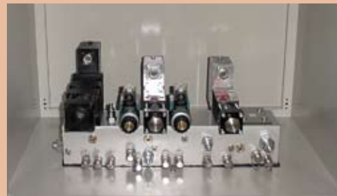
Hydraulventiler monteras i skåp vid maskinen
